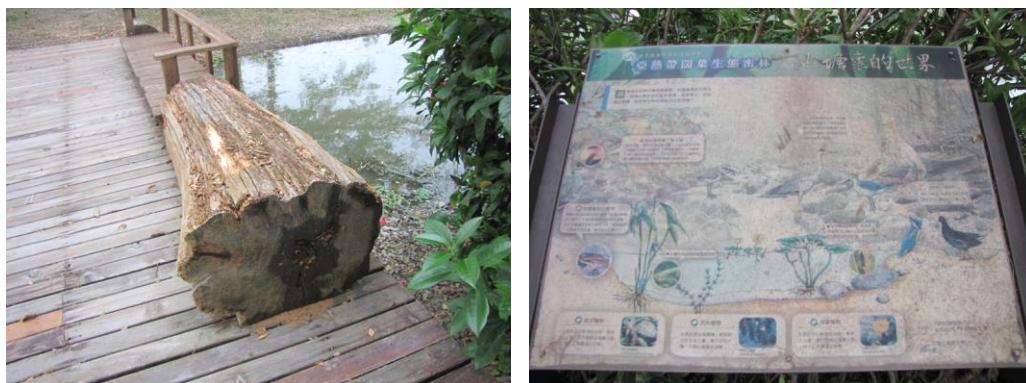
圖 3-7 木椅腐朽情形
