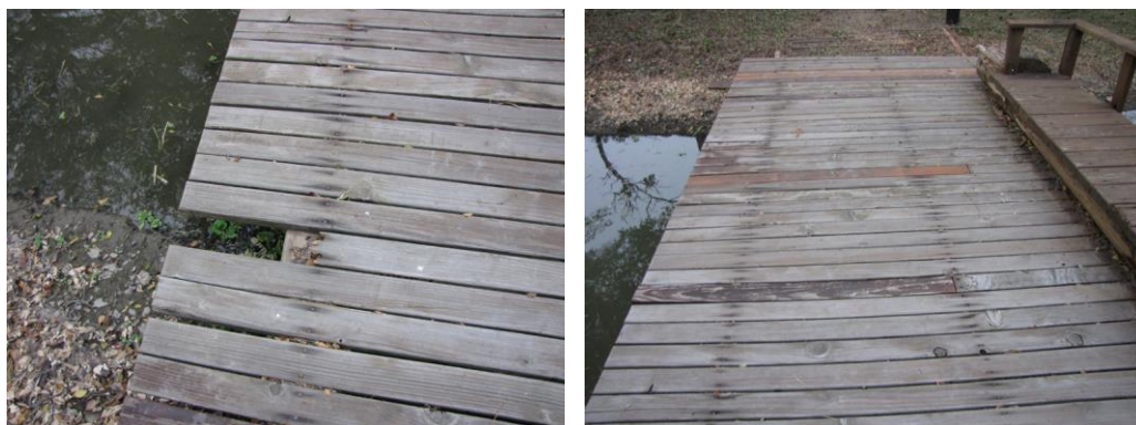
圖 3-6 木橋損壞及修補情形
